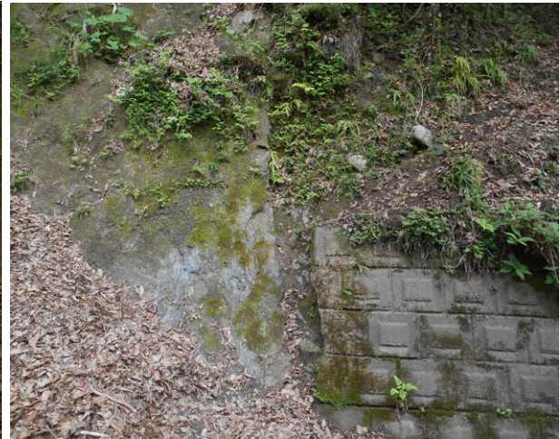
断層箇所は正面の垂直部分だそうです？
