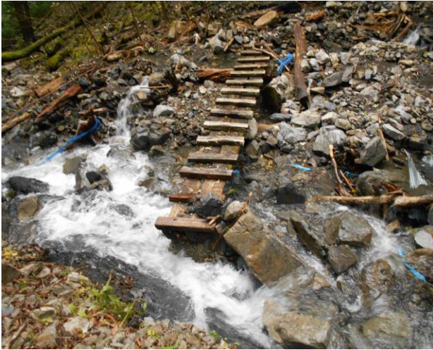
カンバ谷の橋ですが 台風の影響で 岸が崩れて、渡ることが出来ない
