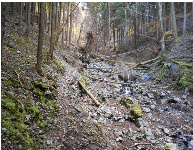
崩落箇所ですがこの先マリコ橋の手前 200mが大崩落箇所登山道は無くなっていた
