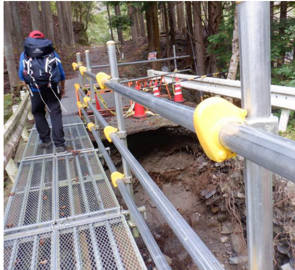
崩落場所の仮橋
