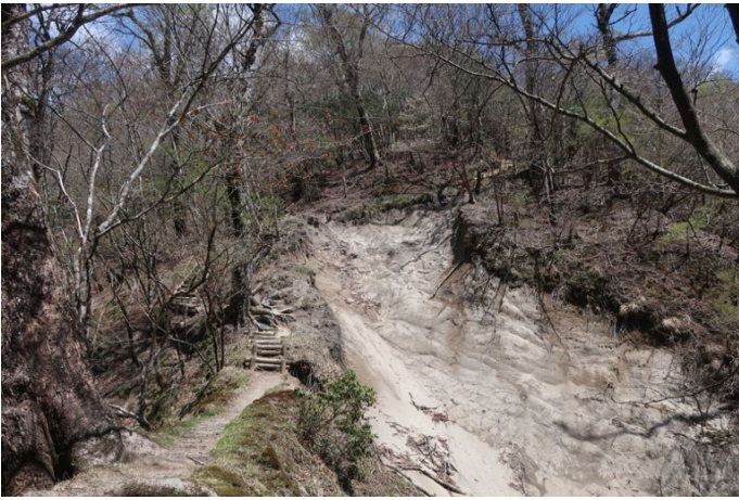
大滝峠上に行く道の途中の大規模な崩壊地 迂回路が整備されていました
